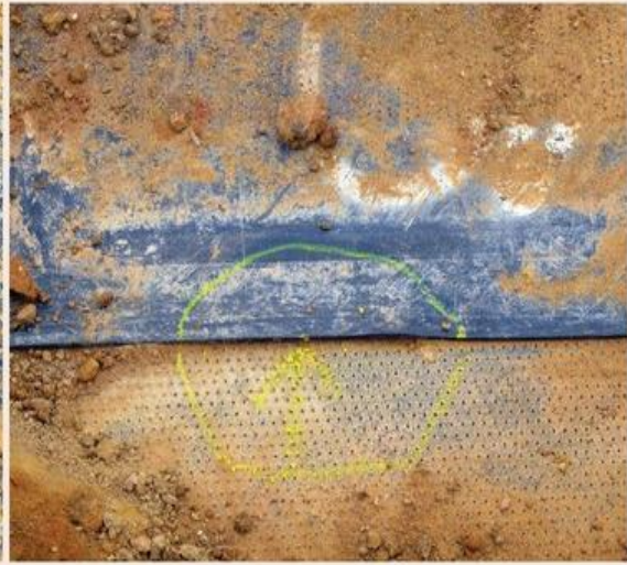
Fig. 3: Falha identificada na solda da emenda entre as geomembranas.
