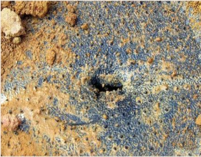
Fig. 2: Dano causado à geomembrana durante a instalação.
